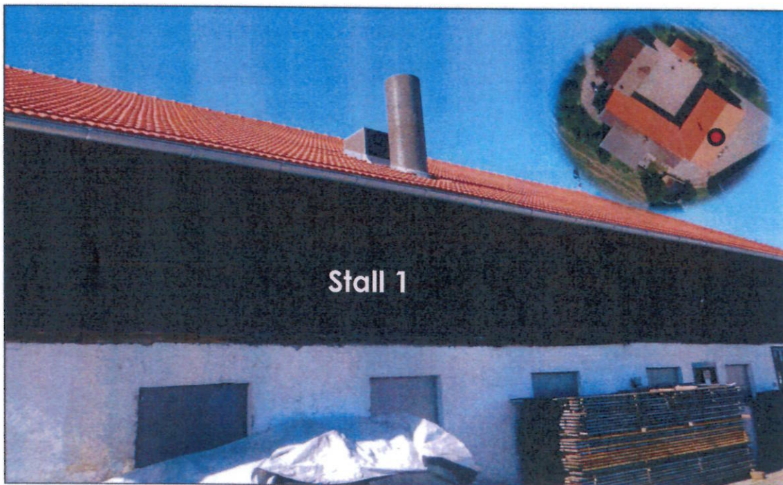
Abbildung 6: Abluftkamin an der östlichen Dachfläche des Stall 1
