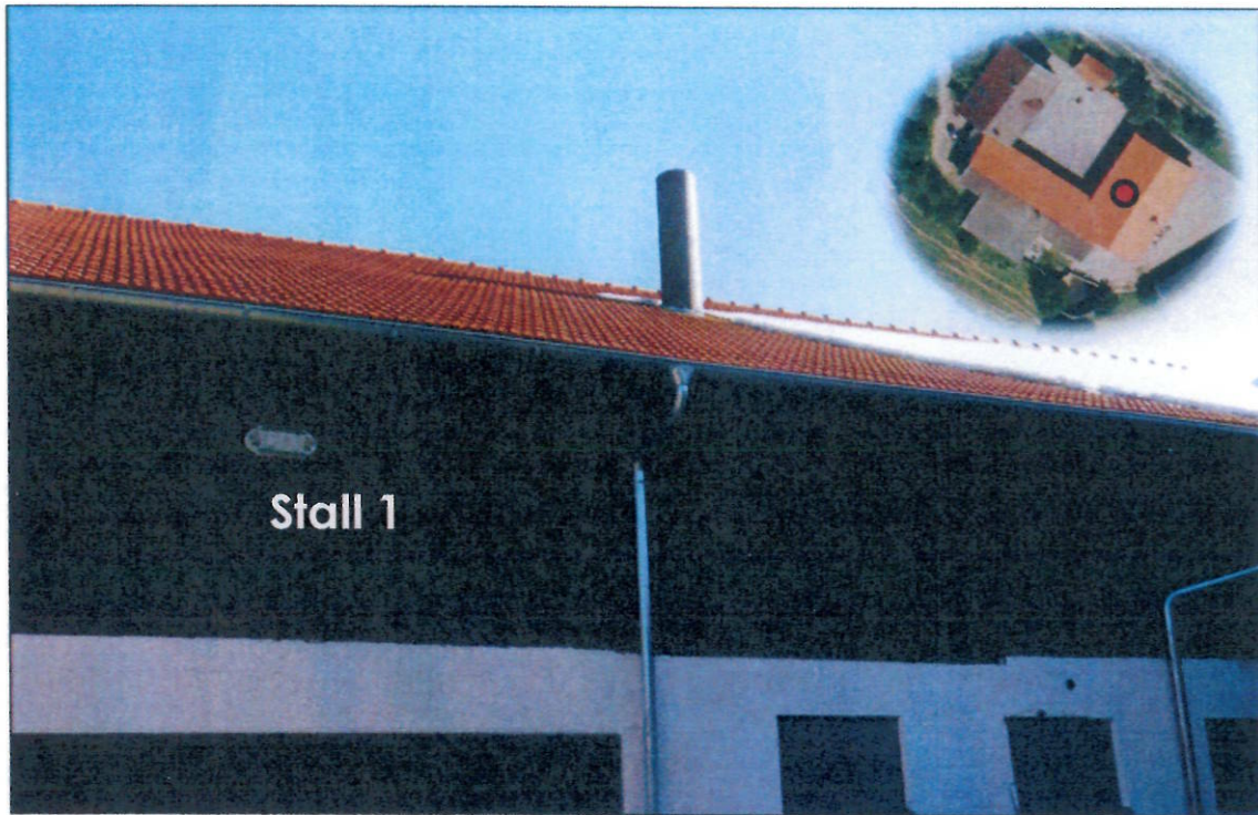
Abbildung 7: Abluft an der westlichen Dachfläche des Stall 1
